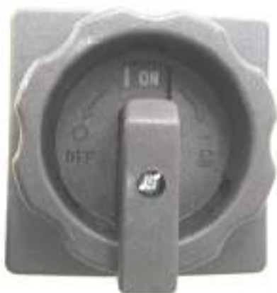
Figura 13: Interruttore di alimentazione del trasformatore di tensione e frequenza nella posizione "ON" (acceso)
